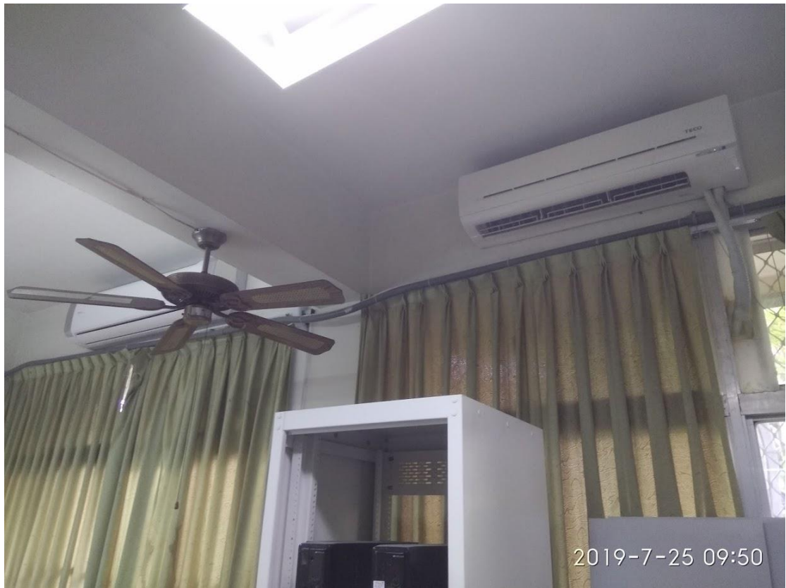
本機房，24 小時冷氣開放。
